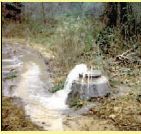
Desbordamientos del alcantarillado (SSO, siglas en inglés)
